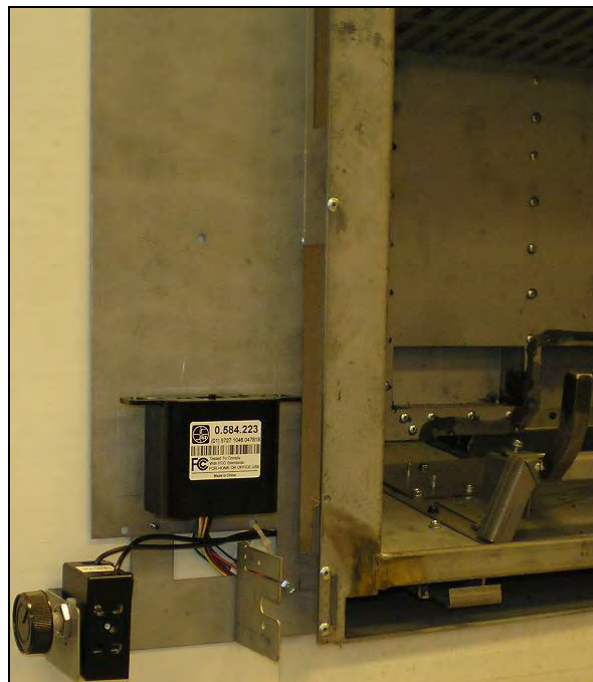
Emplacement du récepteur avec pièces à l'extérieur.
